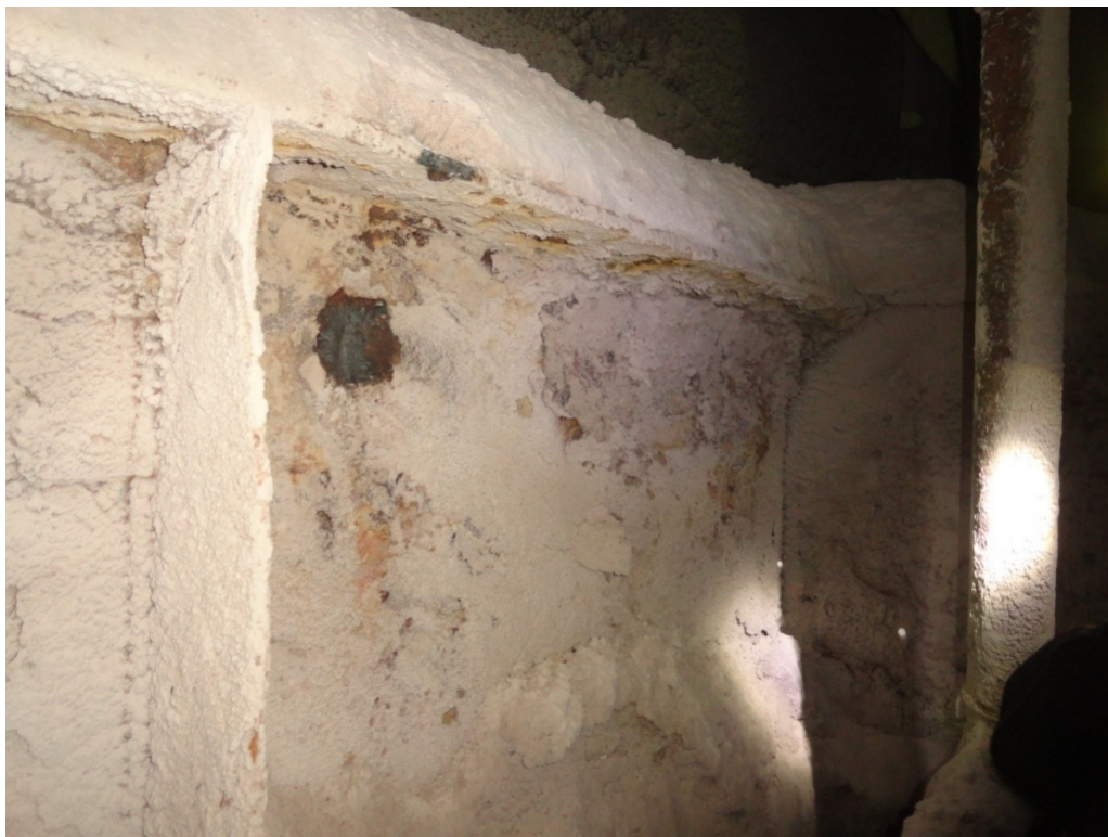
Рис 2. Отложение соли на поверхности конструкций копра высотой до 150 мм.
