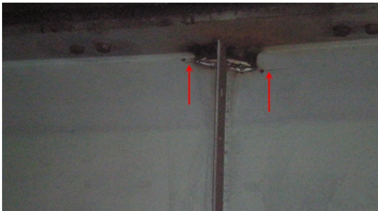
Рис. 2. Усталостная трещина в верхней зоне стенки балки.
