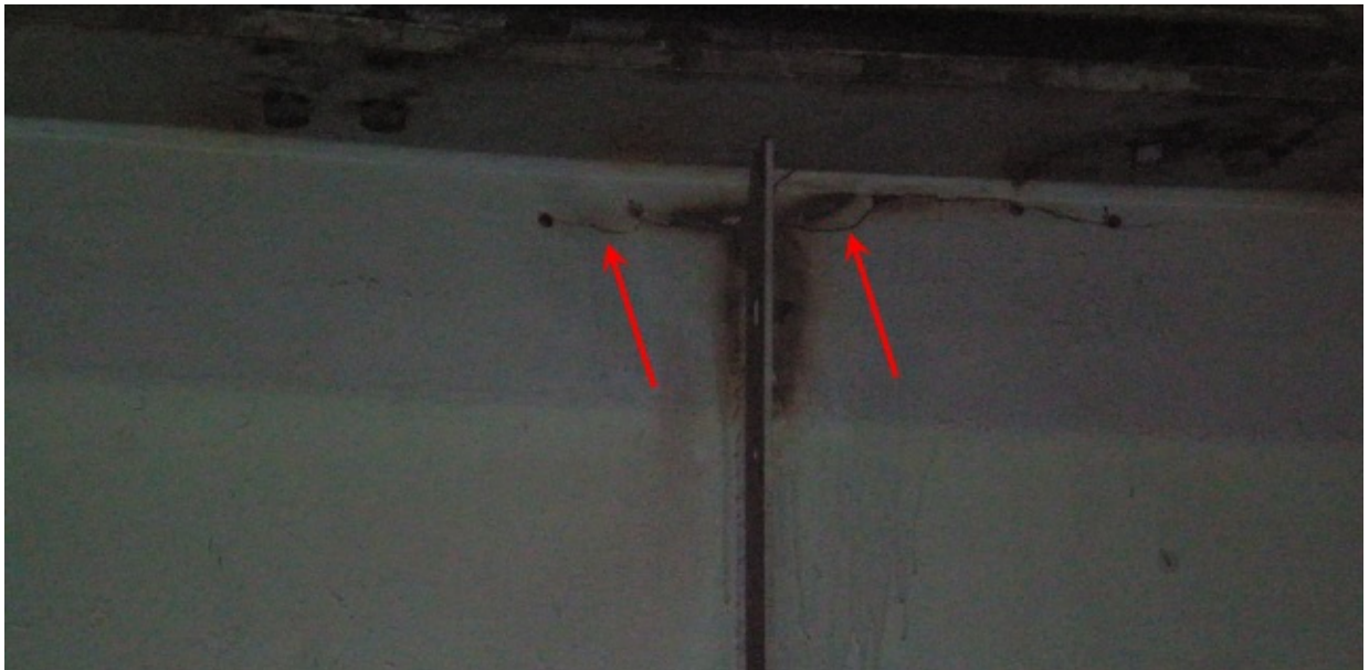
Рис. 1. Усталостные трещины в верхнем пояском шве и шве крепления опорного ребра.
