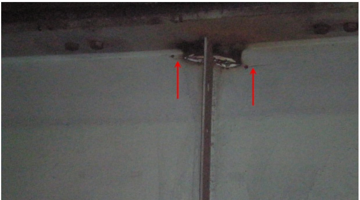
Рис. 2. Усталостная трещина в верхней зоне стенки балки.
