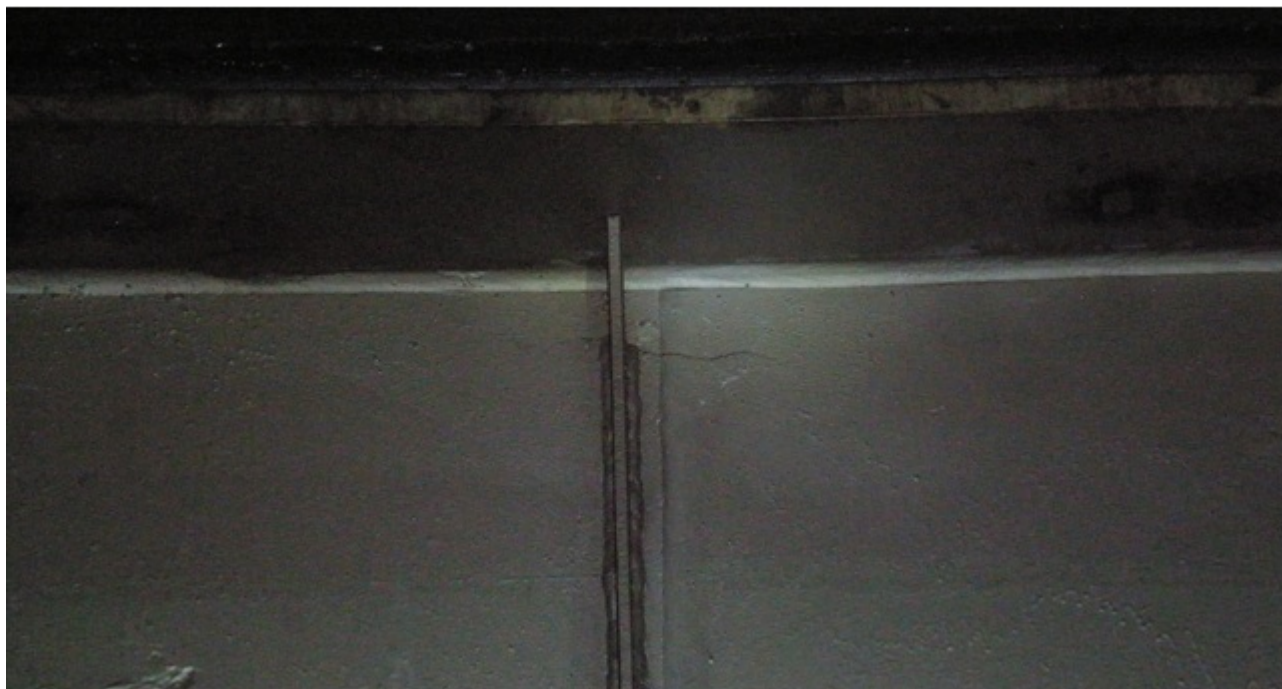
Рис. 3. Наличие концентраторов напряжений в стенке (сварные швы расположены на расстоянии не более 10 мм друг от друга).
