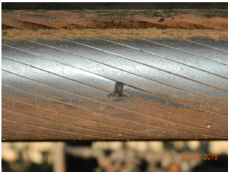
Рис. 2 Обрыв проволоки наружного слоя
