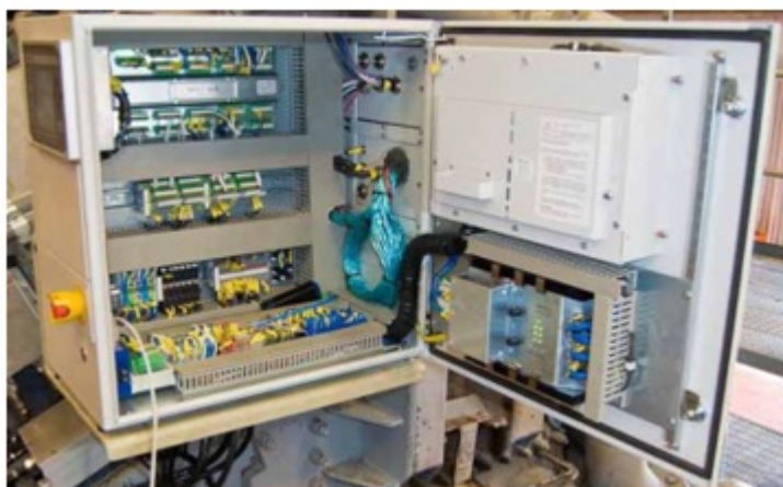
Рисунок 25 — Шкаф системы UNIC C3 — вид изнутри
