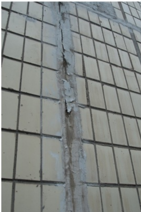
Рисунок 3 — Состояние швов через три года после ремонта
