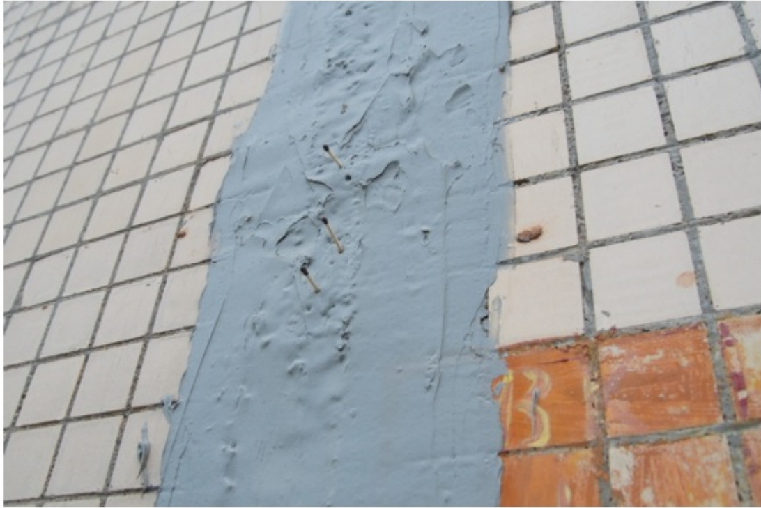
Рисунок 2 — Состояние межпанельных швов через пол года после ремонта
