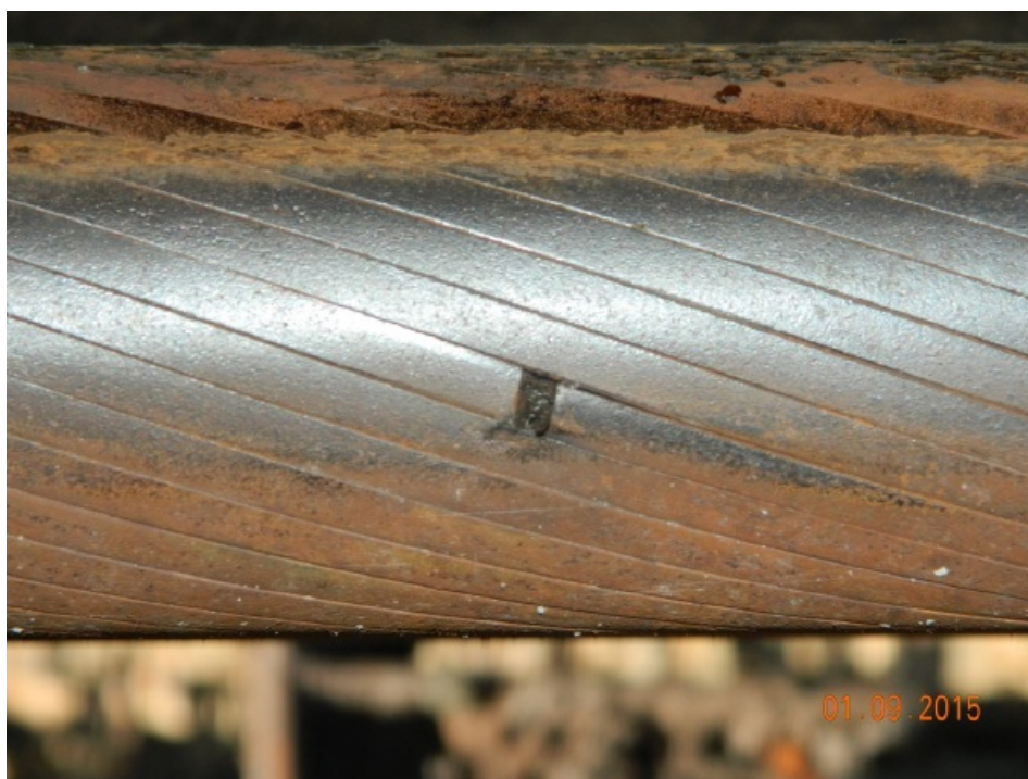
Рис. 2 Обрыв проволоки наружного слоя
