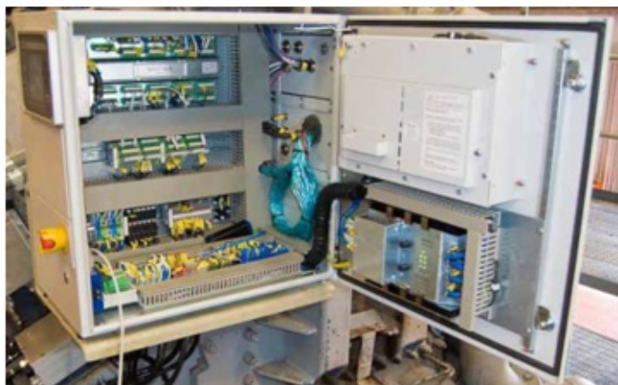
Рисунок 25 — Шкаф системы UNIC C3 — вид изнутри
