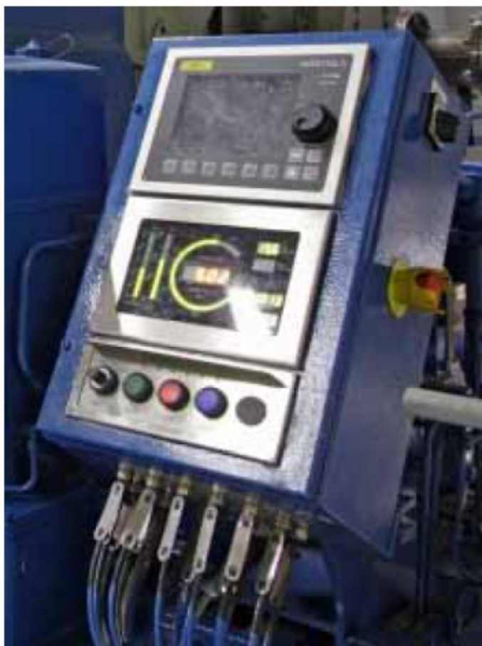
Рисунок 24 — Установка системы UNIC C3 на двигателе
