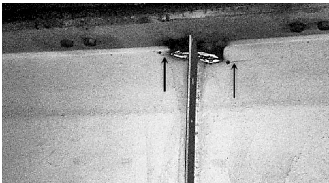
Рис. 2. Усталостная трещина в верхней зоне стенки балки.
