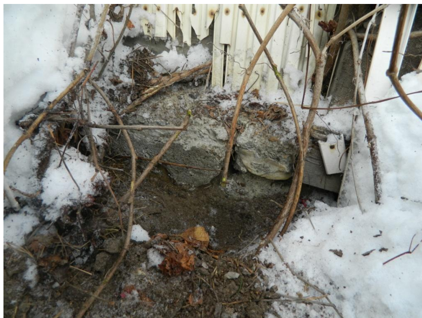
Рис. 2. Пример общего вида дефектов конструкции фундамента.
