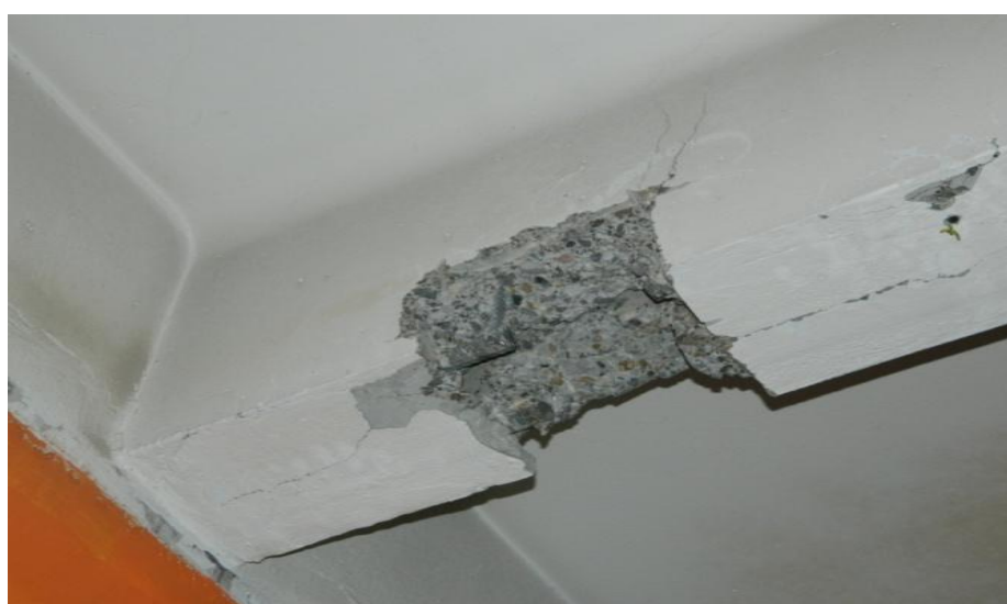
Рис. 1. Механическое разрушение продольных ребер плит покрытия. Вертикальные трещины в продольных ребрах переходящие на полку плит шириной раскрытия 1,0...3,0 мм. Обрезаны рабочие стержни продольных ребер. Плиты в аварийном состоянии.
