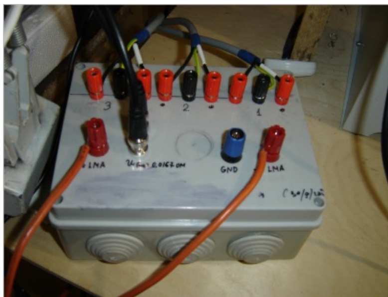
Фото. 14. Блок согласующих трансформаторов БСТ №2 для частот несущей от 16 до - 46 КГц в момент настройки в резонанс антенного контура тока "возбуждения".
