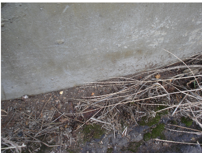
Рис.2. Нарушения целостности каменных (железобетонных) опор горизонтальных резервуаров.
