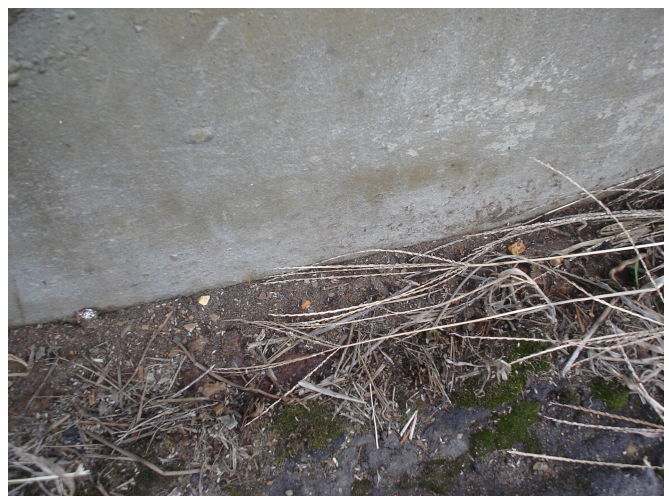
Рис.3. Разрушения отмостки вертикальных резервуаров от внешних и внутренних источников воздействий.
