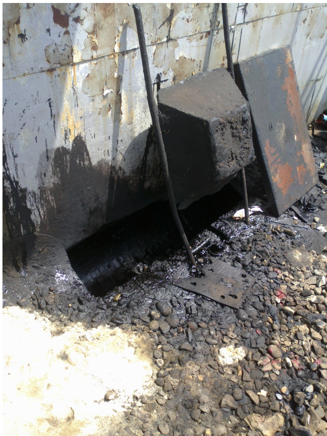
Рис.4. Нарушения антикоррозионного и поверхностей лакокрасочного покрытия, течи арматуры.
