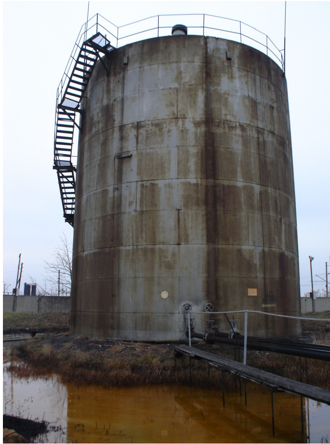
Рис.1. Нарушение технологии монтажа, неудовлетворительная подготовка основания и несоблюдение геометрии, при изготовлении и монтаже резервуара (вертикальные резервуары объемом 2000 куб.м.), отсутствие организованного водоотвода;
